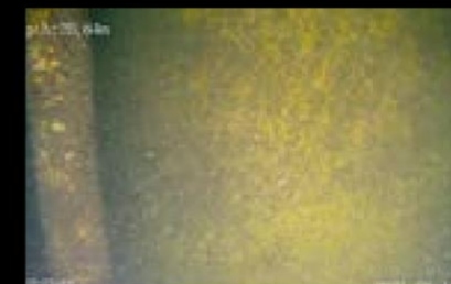
Inspekcje podmywania fundamentów
