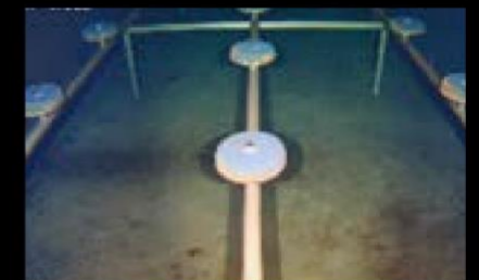
Inspekcje tarcz napowietrzających
